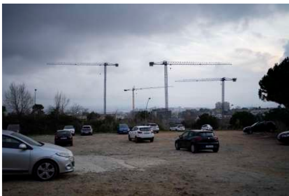
Vistas a las obras del proyecto Pla Caufec, donde se están construyendo bloques de pisos de lujo a los que las familias trabajadoras no tendrán acceso.
